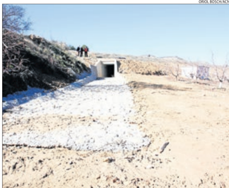
Un dels desaigües de l'A-14 que arriba a una finca de Torrefarrera.
